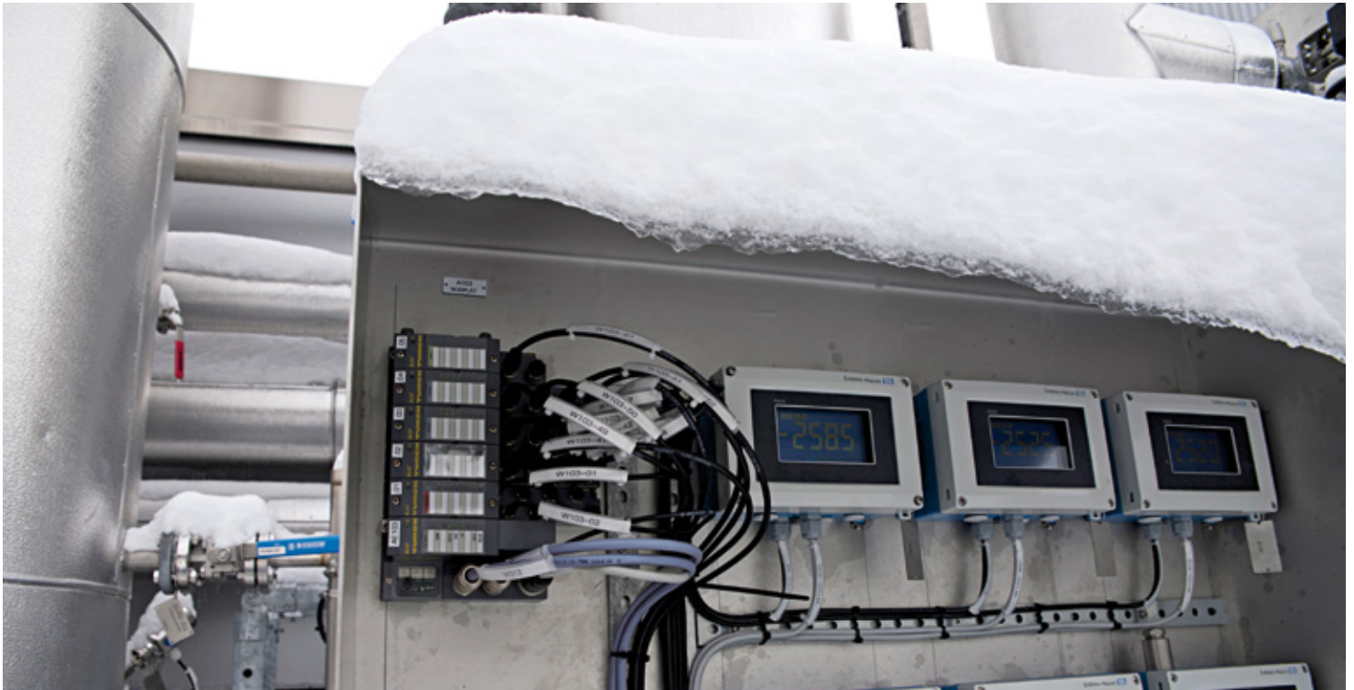
Mit einem Temperaturbereich bis zu -40^{\circ}\text{C} widersteht Turcks BL67-System sogar dem schwedischen Winter
