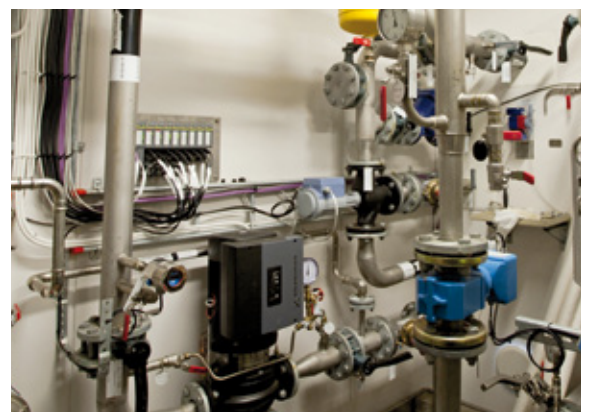
Im CAPure-Raum verbindet BL67 alle Sensoren mit dem Profibus der Anlage
