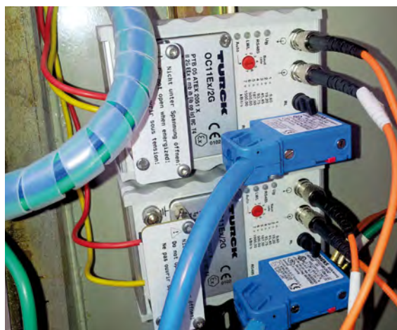
Die Optokoppler bringen das Profibus-Signal von der excom per Lichtwellenleiter zum Leitsystem
