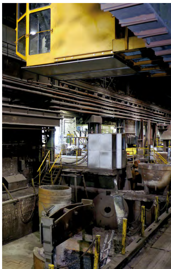
In der Steuerkabine (oben rechts) sieht der Kranführer alle Temperaturen der relevanten Pfannen
