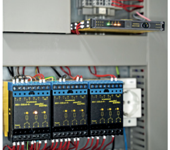
Einfache Nachrüstung der Schaltschränke: Der geringe Aufwand bei Montage und Inbetriebnahme der IM12-CCM überzeugte die Spezialisten der e-netz Süd Hessen AG
