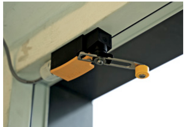
Unsichere Türkontakte oder aufwendig zu montierende Rollenschalter kamen für die Nachrüstung der Schaltschranküberwachung nicht in Frage
