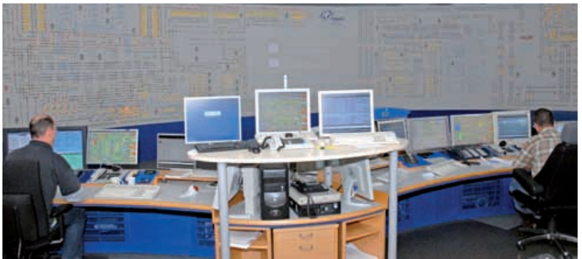
In der Schaltzentrale der Gepäckförderanlage am Frankfurter Flughafen laufen alle Informationen zusammen
