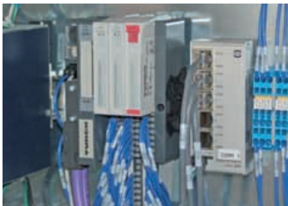
Das Remote-I/O-System BL20 bringt die Peripherie-Signale per Profibus an die Steuerung
